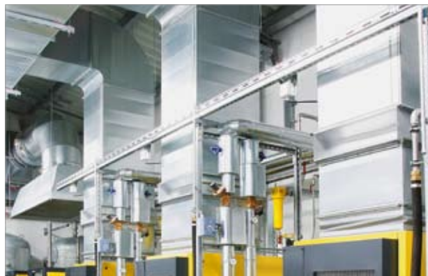
Ventilační kanál k vytápění přilehlých místností
